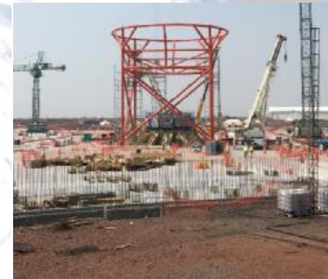
Estructura para soportar un "Fonil"
